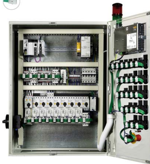
Reálná ukázka průmyslového rozváděče se SmartWire-DT
